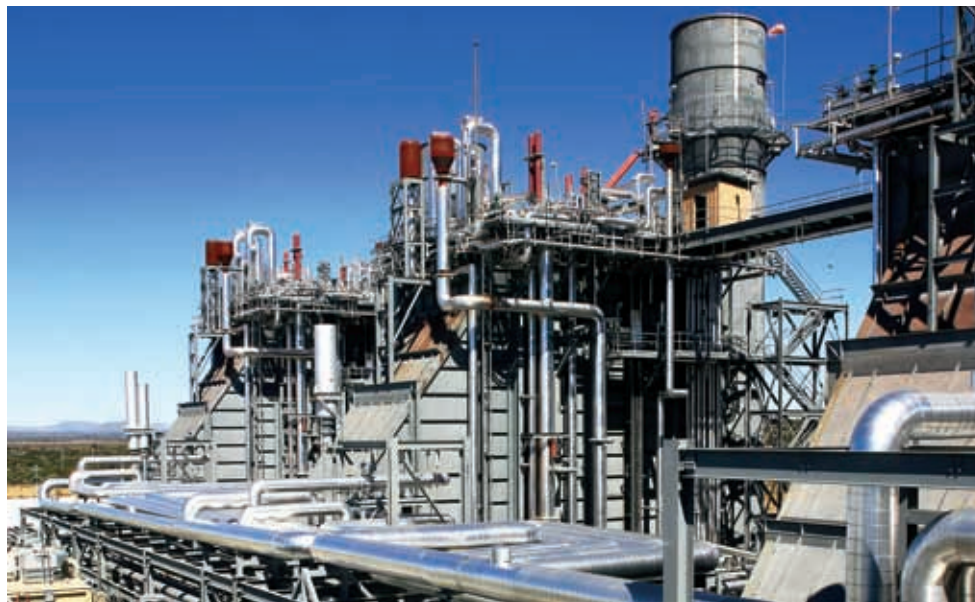
Central eléctrica, México.
